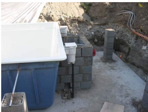
Schacht für Gegenstromanlage
