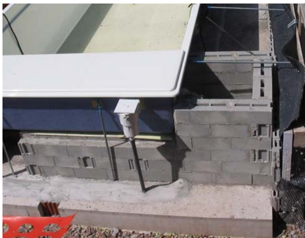
Schacht für Antrieb der Unterflurabdeckung
